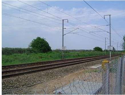
Ligne de contact 25 kV.
